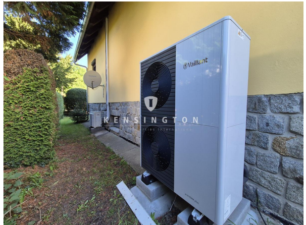
Wärmepumpe und Klimaaggregat
